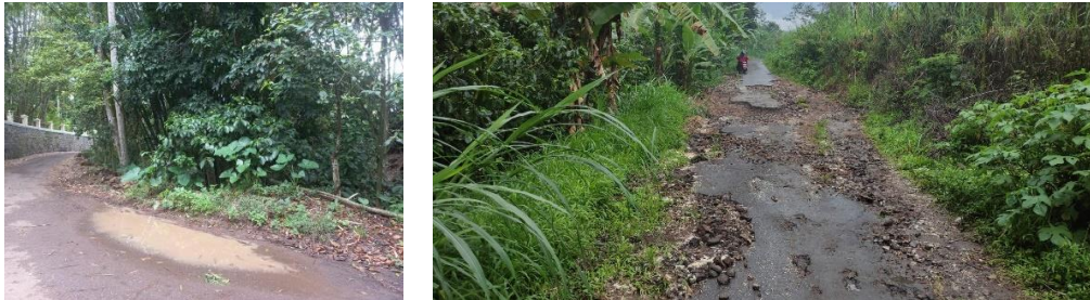
Gambar 4. Kondisi jalan yang kurang baik Sumber: Dokumentasi Tim, 2022
